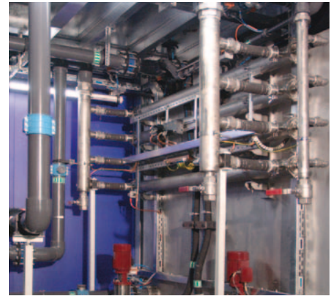
Ultrafiltrationseinheit mit vier Druckrohren mit je zwei Membranen
