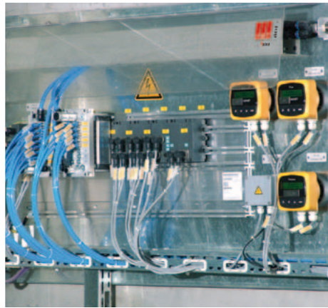
Ventilinseln zur automatischen Klappensteuerung
