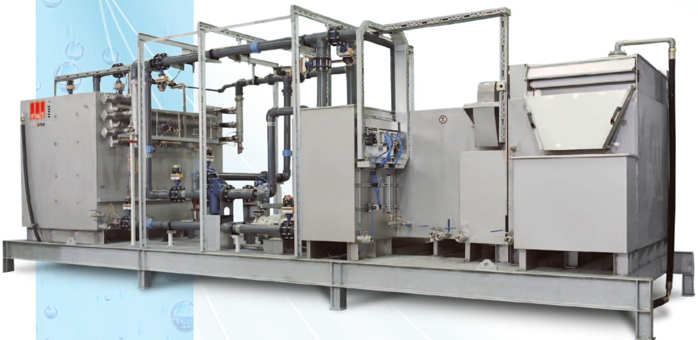
Mehrstufige, auf Plattform aufgebaute Wasseraufbereitungsanlage Standort Mexico
