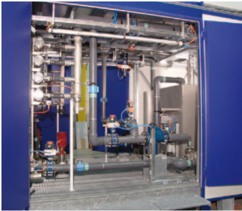
Innenansicht der WAA mit Aufkonzentrations-Tank
