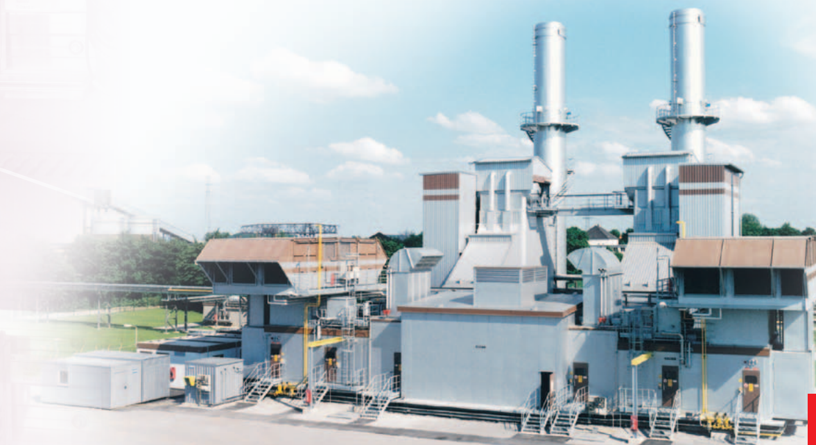
Steuerung und Visualisierung zweier Gasturbinen als Generatorantrieb mit jeweils einem nachgeschalteten Abhitzeessel pro Gasturbine
