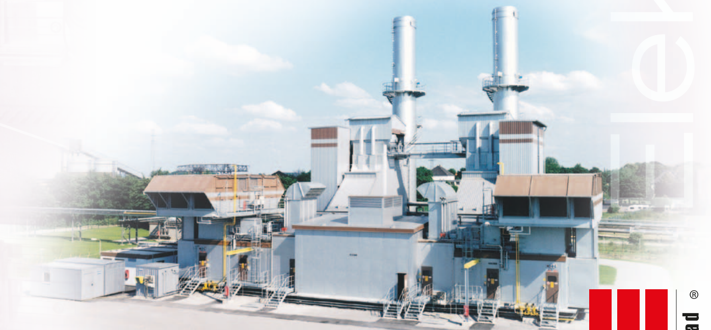
Steuerung und Visualisierung zweier Gasturbinen als Generatorantrieb mit jeweils einem nachgeschalteten Abhitzeessel pro Gasturbine
