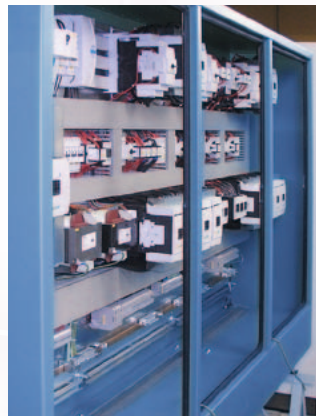
Sondersteuerungen für Werkstatt-Krane – Steuerungstechnik und Blechverarbeitung aus einer Hand
